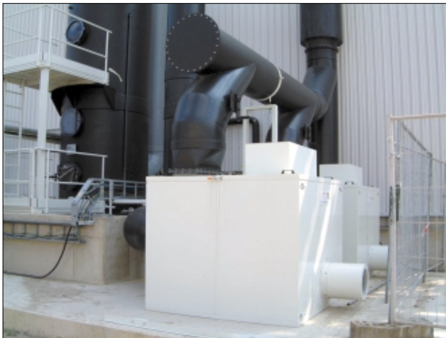
De installatie bestaat uit een aantal opslagtanks en reactorvaten, aangevuld met de nodige piping, pompen, filters en randapparatuur.
